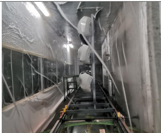
项目涂装生产线现状照片
