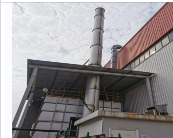
涂装喷漆废气 RTO 燃烧处理设备
