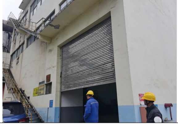
4#线危废处理车间
