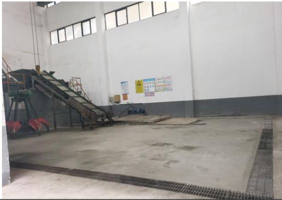
4#线危废处理车间
