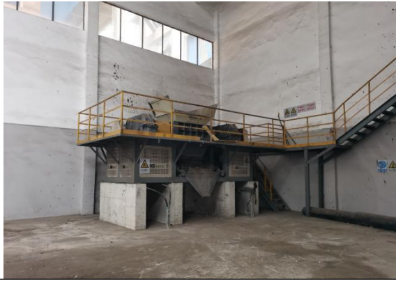
2#线危废处理车间
