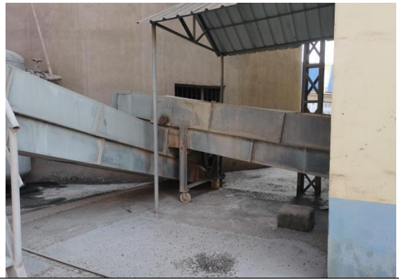
4#线危险废物入窑输送管道
