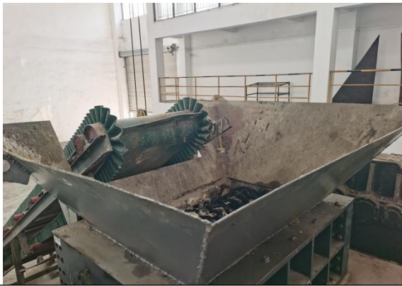
4#线破碎机入料口
