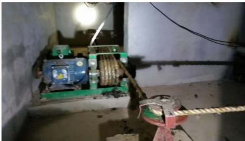
图 2.2-3 项目猪舍刮粪绞龙照片
