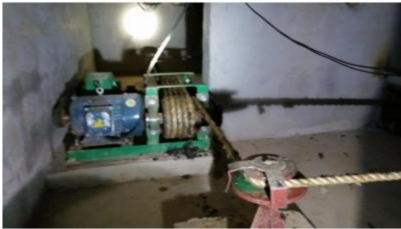
图 2.2-5 猪舍刮粪绞龙工程实例照片
